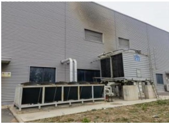
真空灭弧室工艺冷冻水系统
